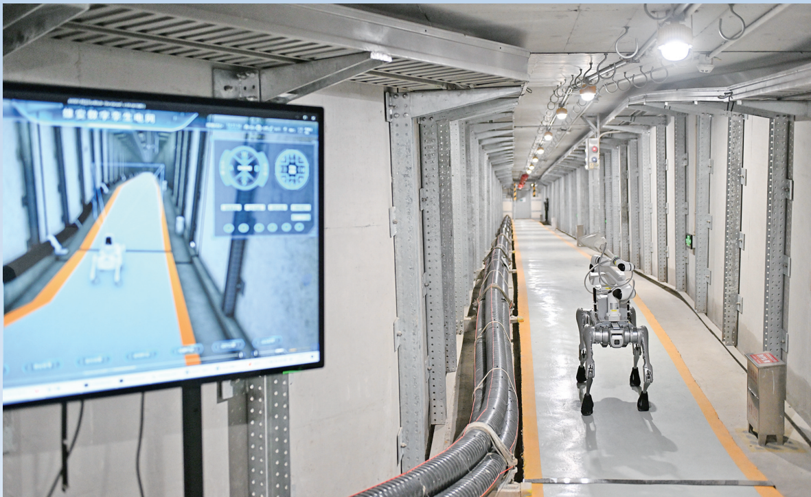
全长16.2公里的雄安新区起步区和昝岗片区稳定电力供应的重任。隧道内敷设的220千伏电缆如同城市的毛细血管,而四足巡检机器人正是守护“血管”健康的“特种兵”。图为机器人在雄安新区雄安电缆隧道内巡检。
