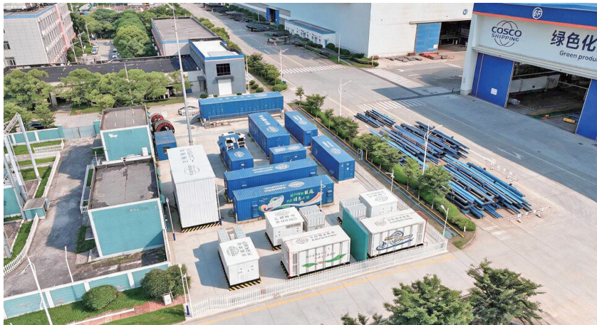
江苏启东中远海运海工建成国内船舶海工行业首个源网荷储一体化微电网（星星充电供图）
