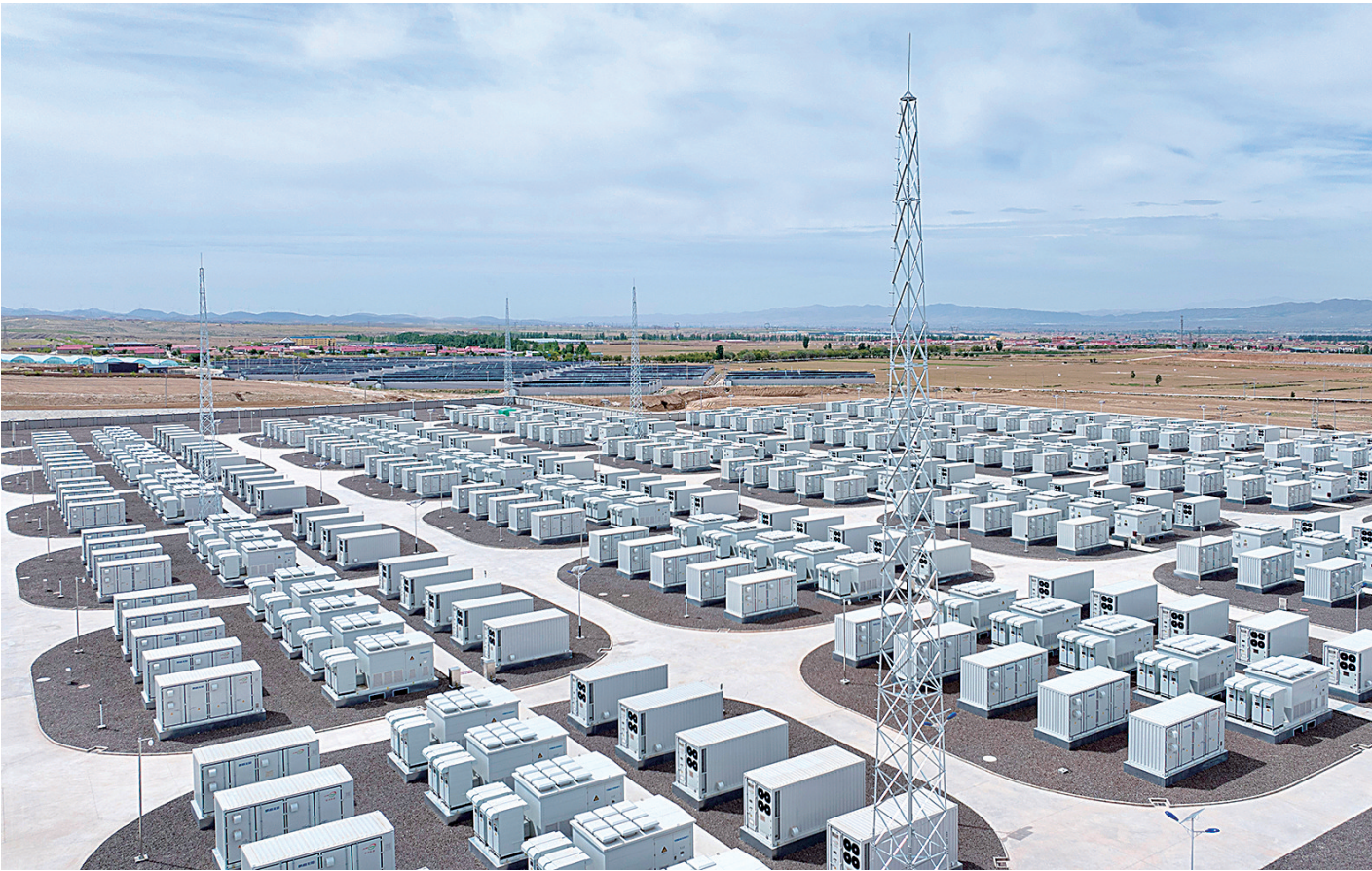
位于宁夏同心县的同心县妙岭1GW/2GWh新型镍氢混合共享储能示范项目
