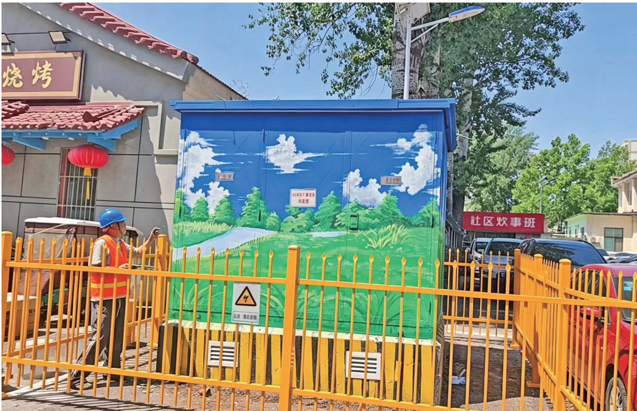
图为国网济南供电公司人员正在对平阴县一中宿舍箱变进行检查。改造后,该小区供电容量提升至630千伏安,户均容量由原来的1kVA增至3.5kVA,满足了居民用电需求,提升了居民居住环境和生活质量。
