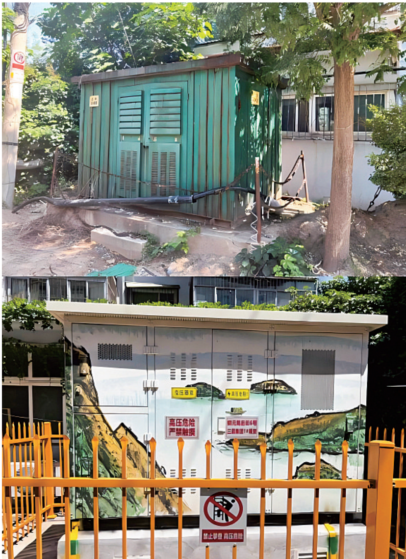
上图为济南市铜元局后街6号院原箱变,下图为改造后箱变。济南市政企协同,加强民事协调,在满足安全距离的同时,将电力设施与小区环境相融合,得到小区居民一致好评。
