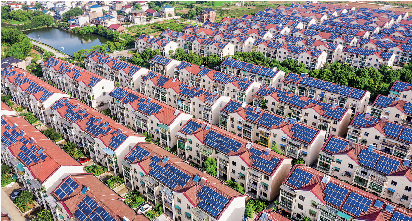
浙江衢州龙游县芝溪家园村屋顶光伏项目
