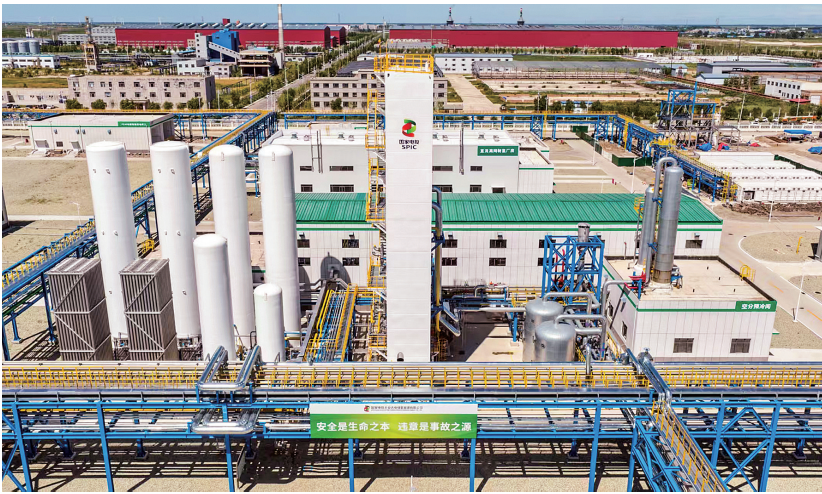
国电投集团电投绿能“氢洲·大安绿氢”项目空气分离装置 (国电投绿色能源股份有限公司供图)
