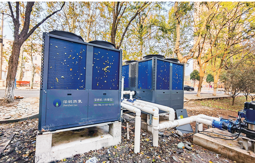
深燃机(供暖型) (深圳市燃气集团股份有限公司供图)
