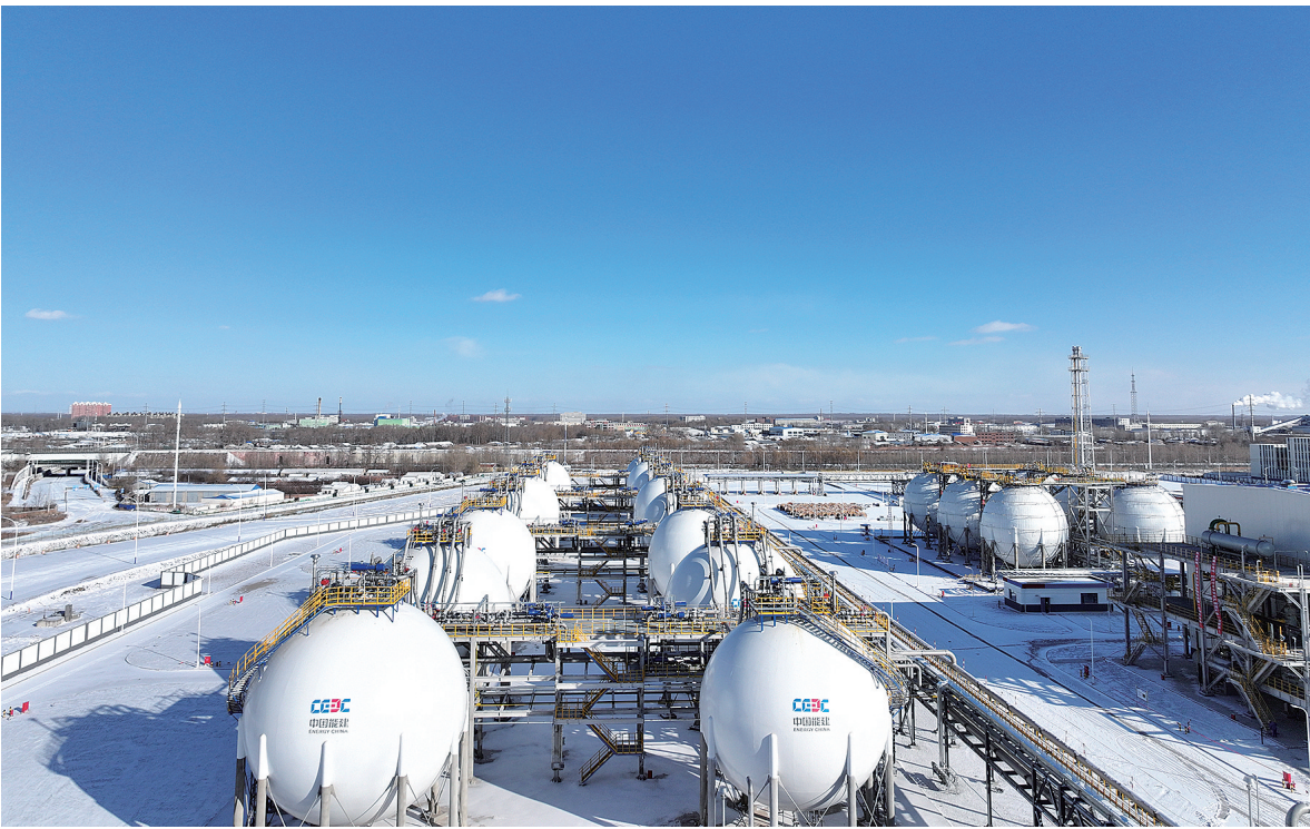
中能建松原氢能产业园(绿色氢氨醇一体化)项目氢气储罐
