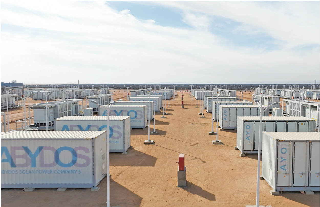
埃及 Abydos 光储项目由来自中国的天合储能提供全套系统解决方案,作为当地首个公用事业级“光伏+储能”一体化项目,已在严苛的沙漠环境中实现稳定运行。
