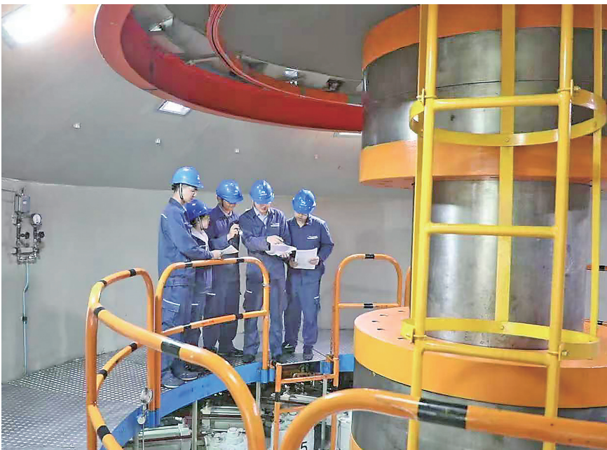
全国产化的首个大型抽水蓄能机组数字智能调速系统已在广州投运,这标志着我国抽水蓄能控制保护能力和装备关键技术实现重要突破。图为工作人员检查运行状态。(南网储能公司供图)
