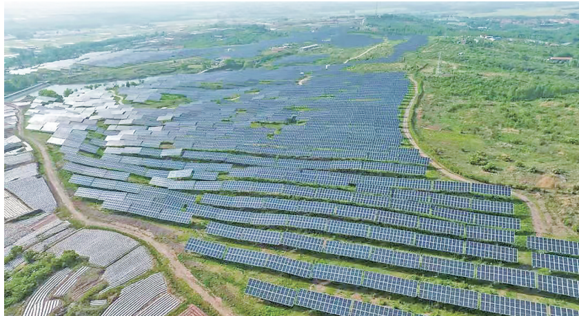
华能莒县长岭60兆瓦光伏发电项目实现全容量并网发电
