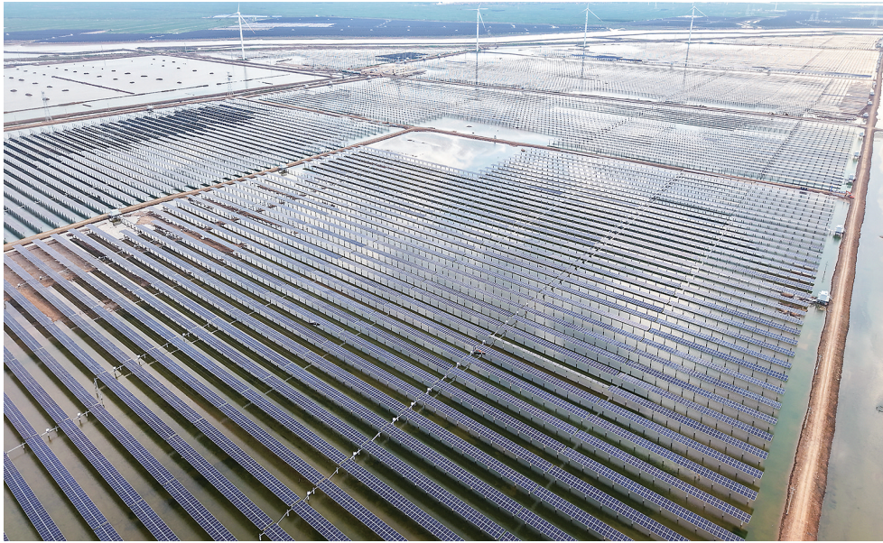
国家电投滨州沾化B12-1(一期)200兆瓦渔光互补光伏发电项目
