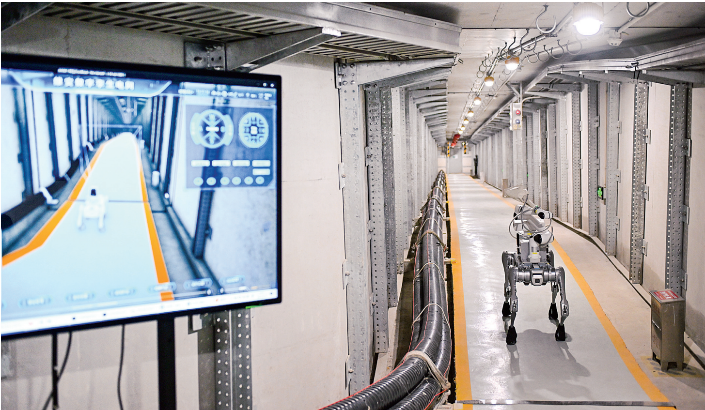
近年来,国网雄安新区供电公司累计投资110亿元,投运500千伏雄东站等31项重点工程,新建、改造35千伏以上线路210.5公里,建成城市智慧能源融合站、5G智慧电缆隧道等标志性工程。图为四足巡检机器人在雄安新区雄东电缆隧道内巡检。 新华社记者 牟宇 摄
