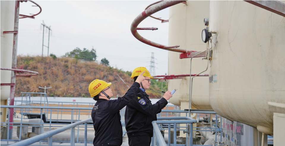
南宁中燃三塘站的场站运行员们正在进行燃气设备设施巡检,确保燃气输配设备设施时刻处于正常的运行工况。(中国燃气供图)
