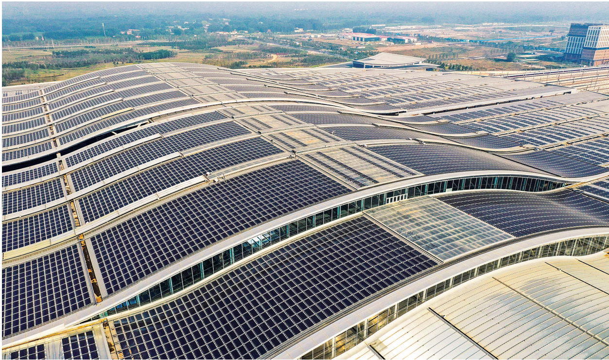
国家能源局日前发布2024年1~11月份全国电力工业统计数据。截至11月底,全国累计发电装机容量约32.3亿千瓦,同比增长14.4%。其中,太阳能发电装机容量约8.2亿千瓦,同比增长46.7%。图为京雄城际铁路雄安站站顶分布式光伏电站。
