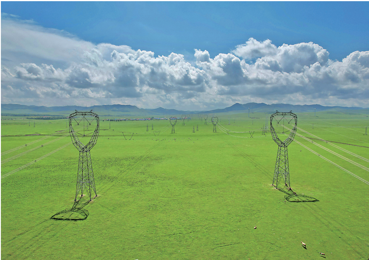
特高压等强网、联网和外送工程不断完善,配电网高质量发展行动有序开展。
