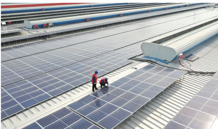
图为国网宁津县供电公司工作人员在迈宝赫健身器材有限公司检查屋顶光伏设备。 梁德华 摄
