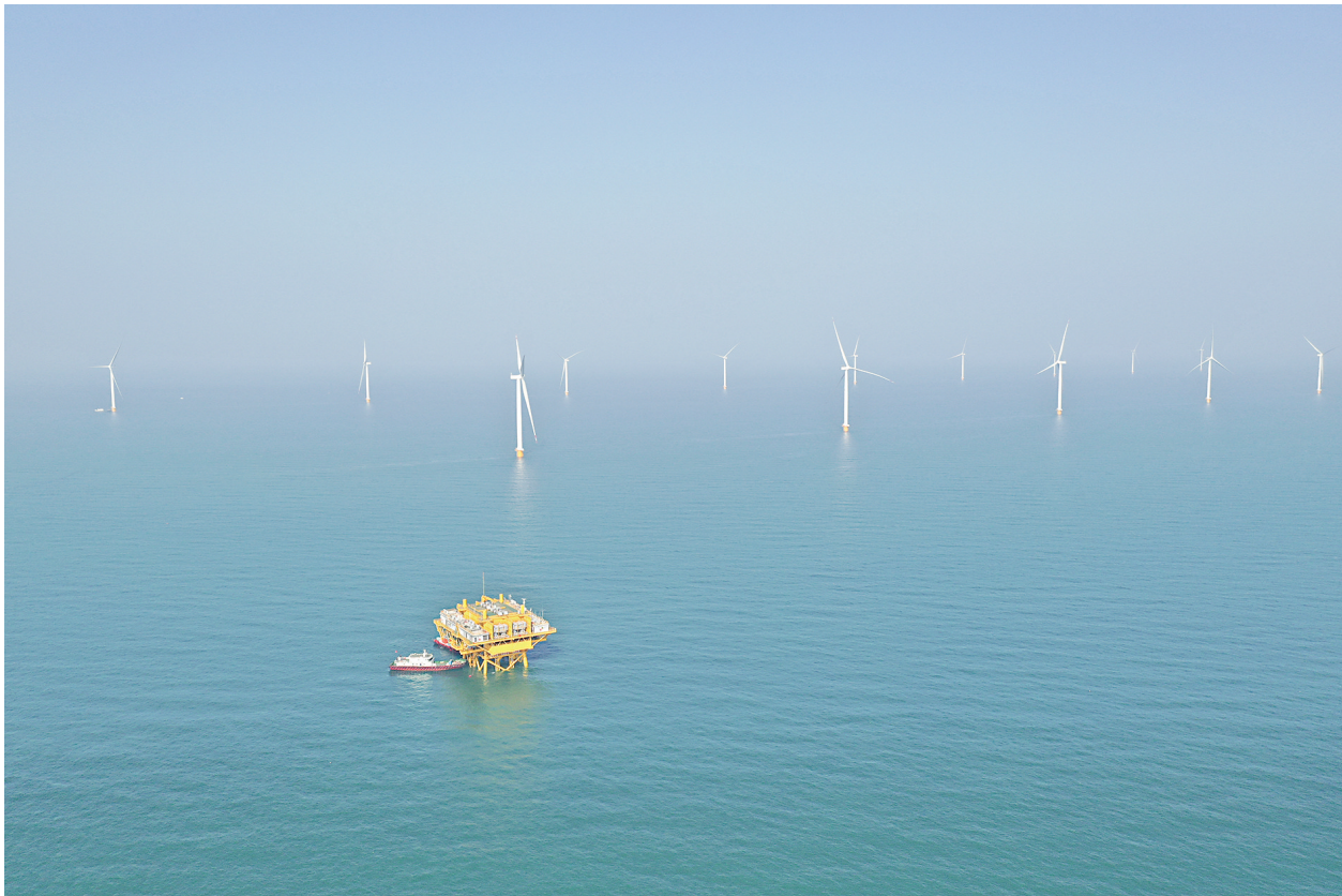
国家电投山东半岛南U场址一期项目在乳山南侧海域全容量并网发电
