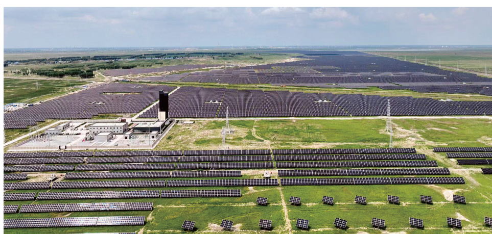
国家光伏、储能实证实验平台(大庆基地)
