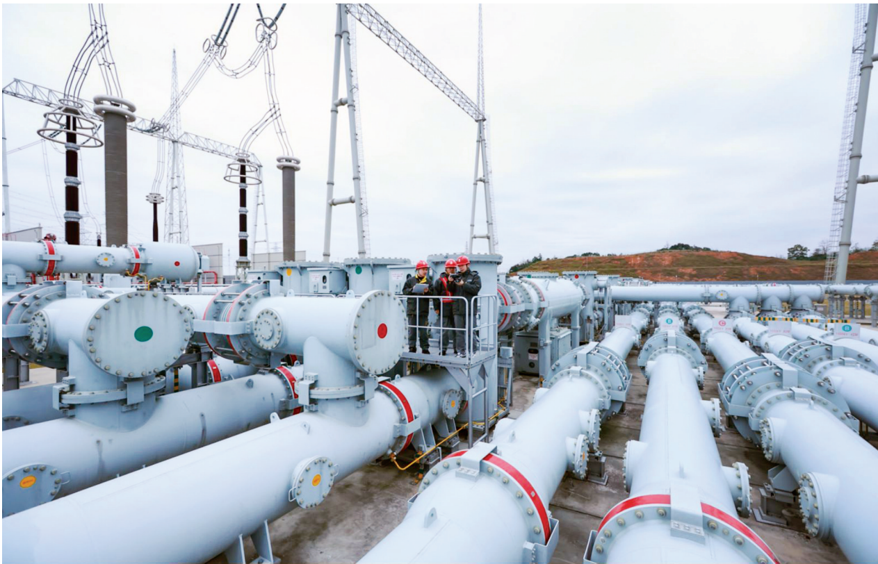
2023年12月16日,在1000千伏交流特高压潇湘站,国网湖南超高压变电公司运维人员正在开展迎峰度冬保电特巡。
