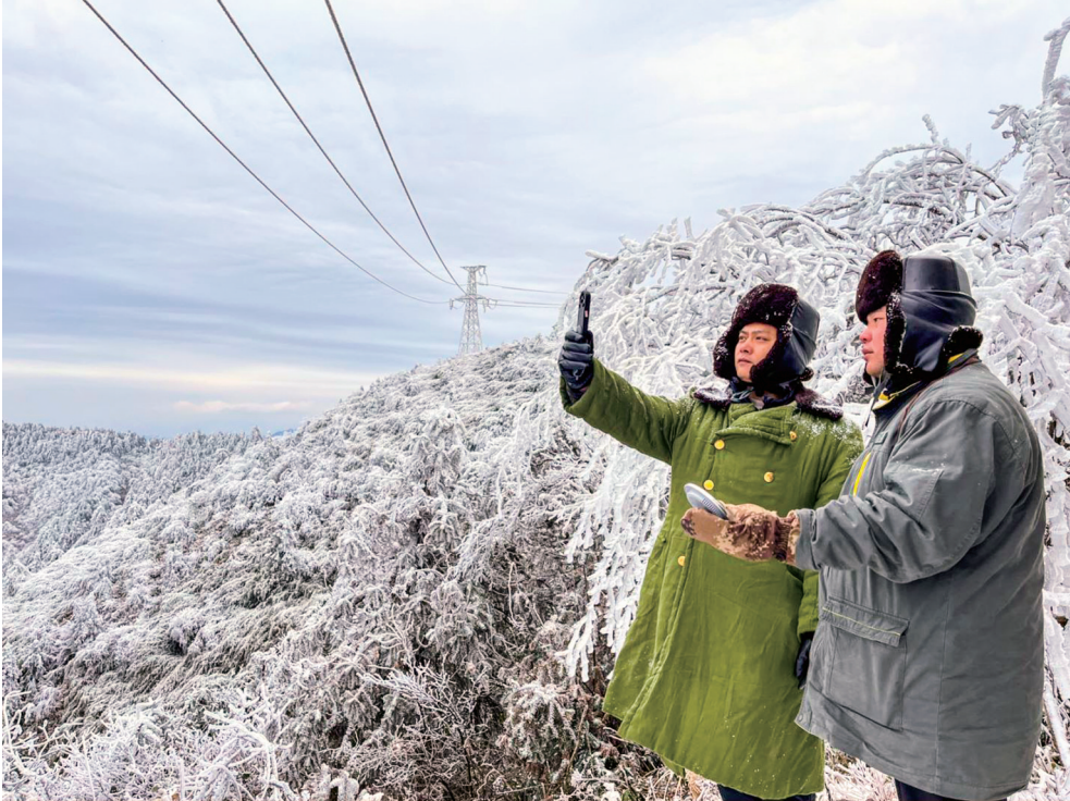
国网怀化供电公司冰情监测人员尹斌、龙昱君在110千伏西公线03号观测点进行融冰观测,查看导线和铁塔覆冰情况,确保线路顺利进行。
