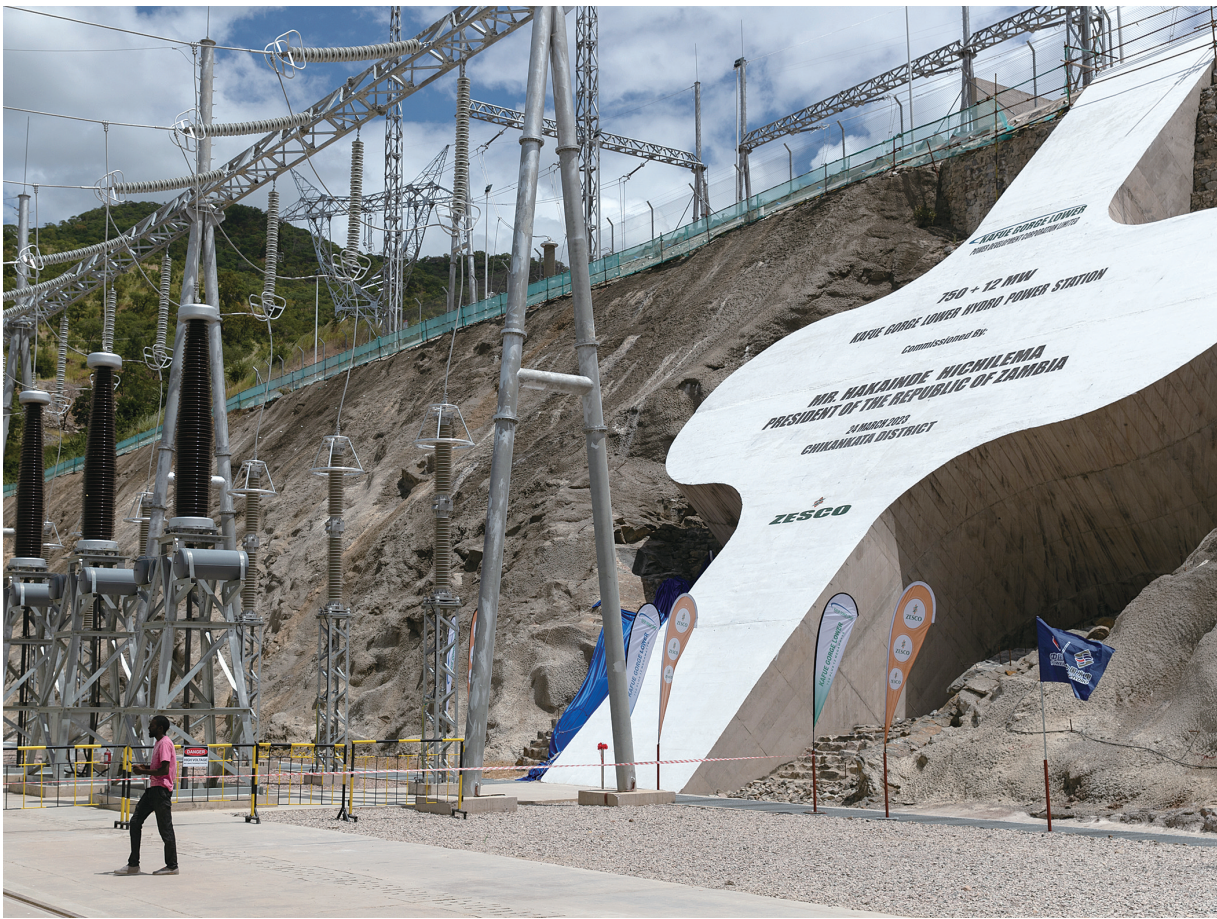
在赞比亚南方省拍摄的下凯富峡水电站主变压器区域
