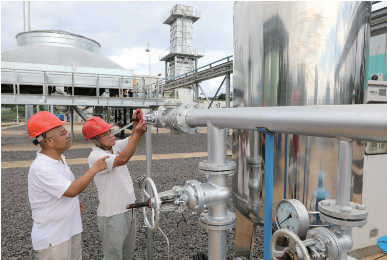
在位于赤道几内亚首都马拉博的马拉博燃气电厂,中方技术人员查看稳压水罐。
