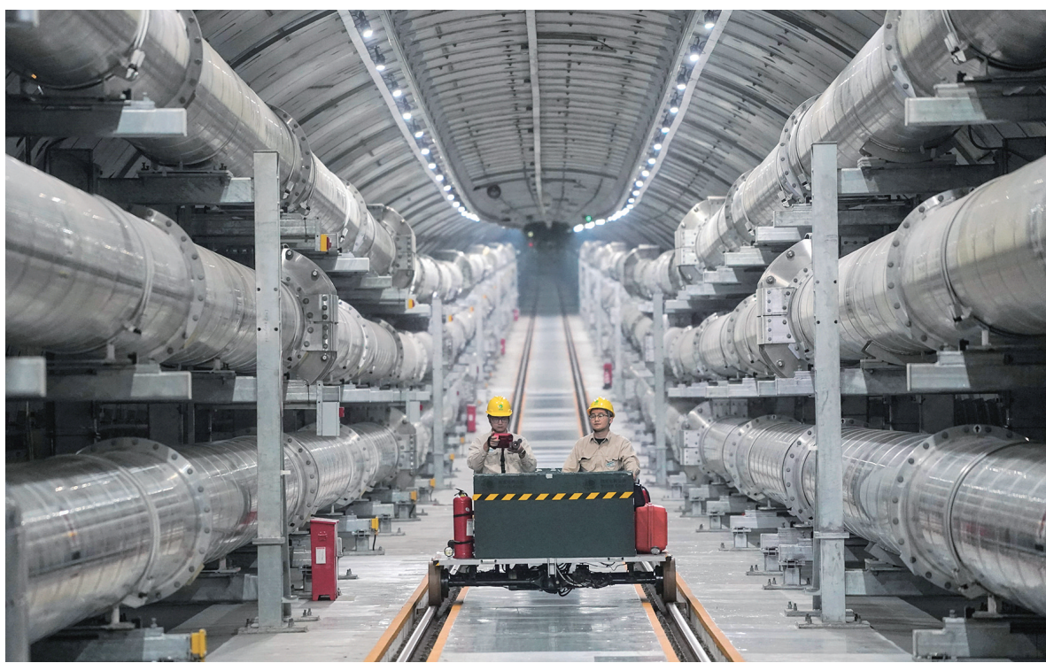
特高压苏通GIL管廊跨江送电破千亿
