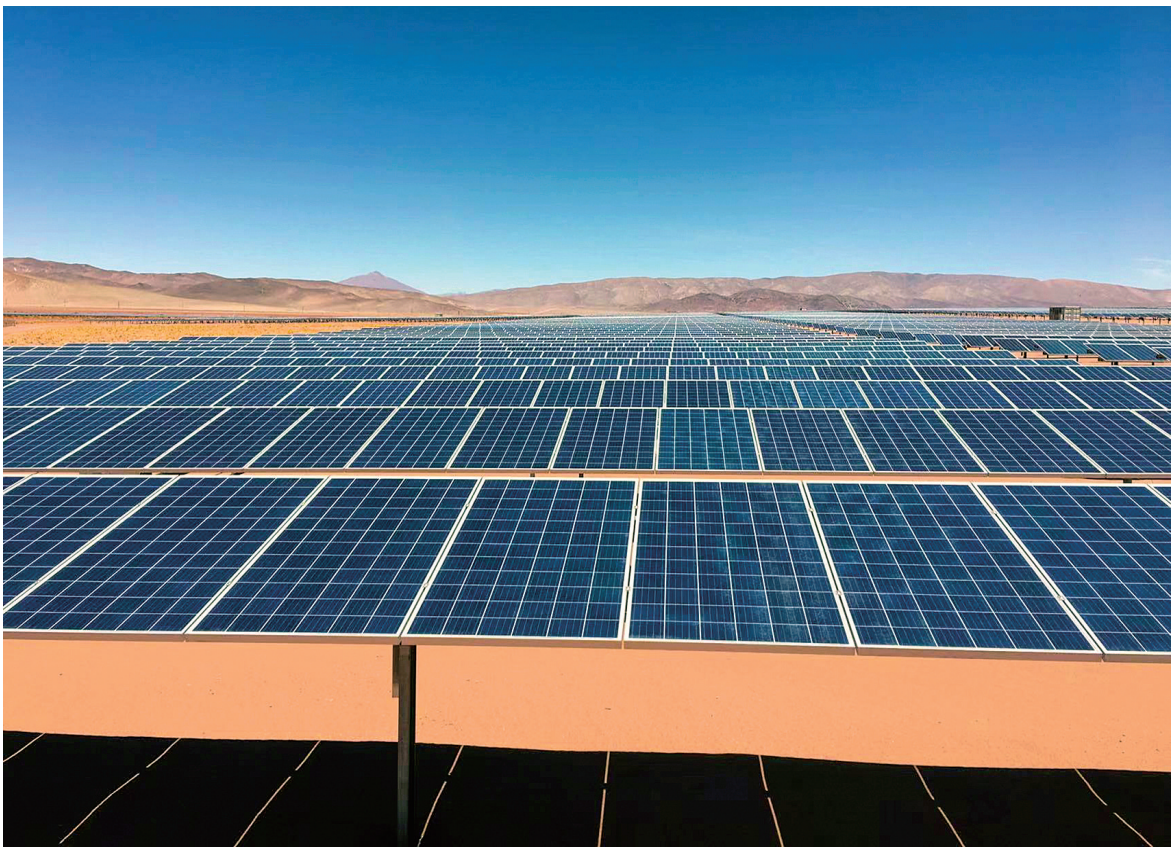
阿根廷胡胡伊省高查瑞光伏电站的光伏板
