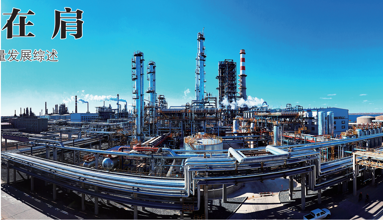
建成投产的大庆石化炼油结构调整转型项目200万吨催化裂化装置
