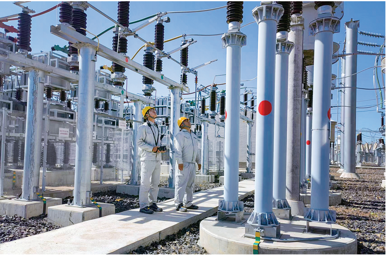
工作人员在塞罕坝区域御道口500千伏变电站开展巡检
