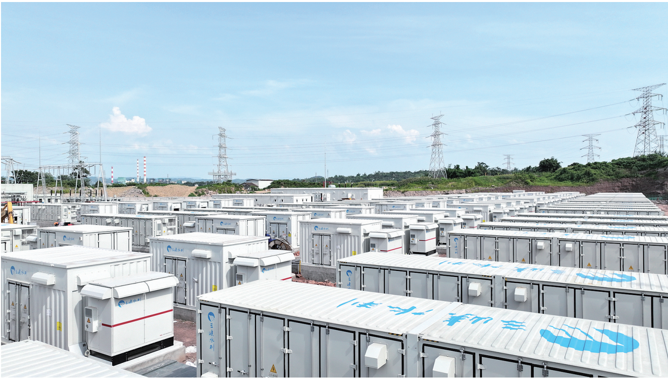
重庆市永川区松溉镇储能电站
