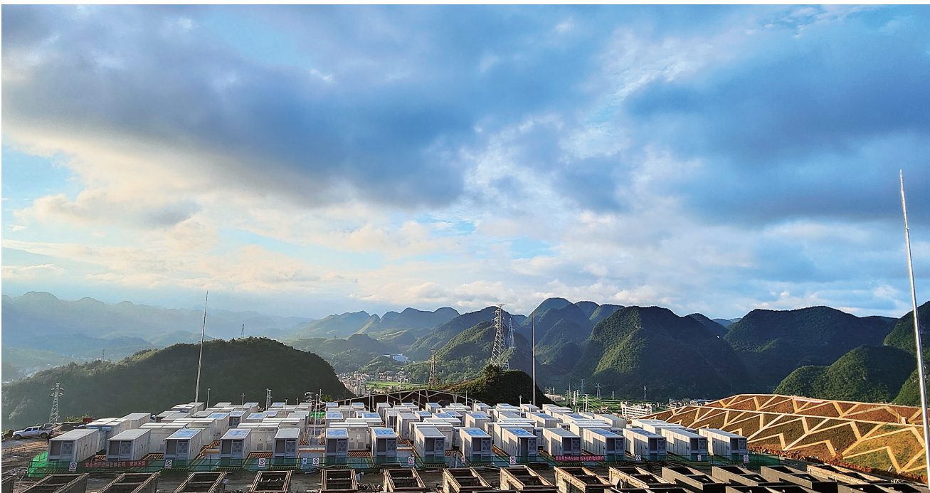
7月19日,贵州省首个大型独立共享储能电站——中核紫云200MW/400MWh储能电站(一期200MWh)并网建成。
