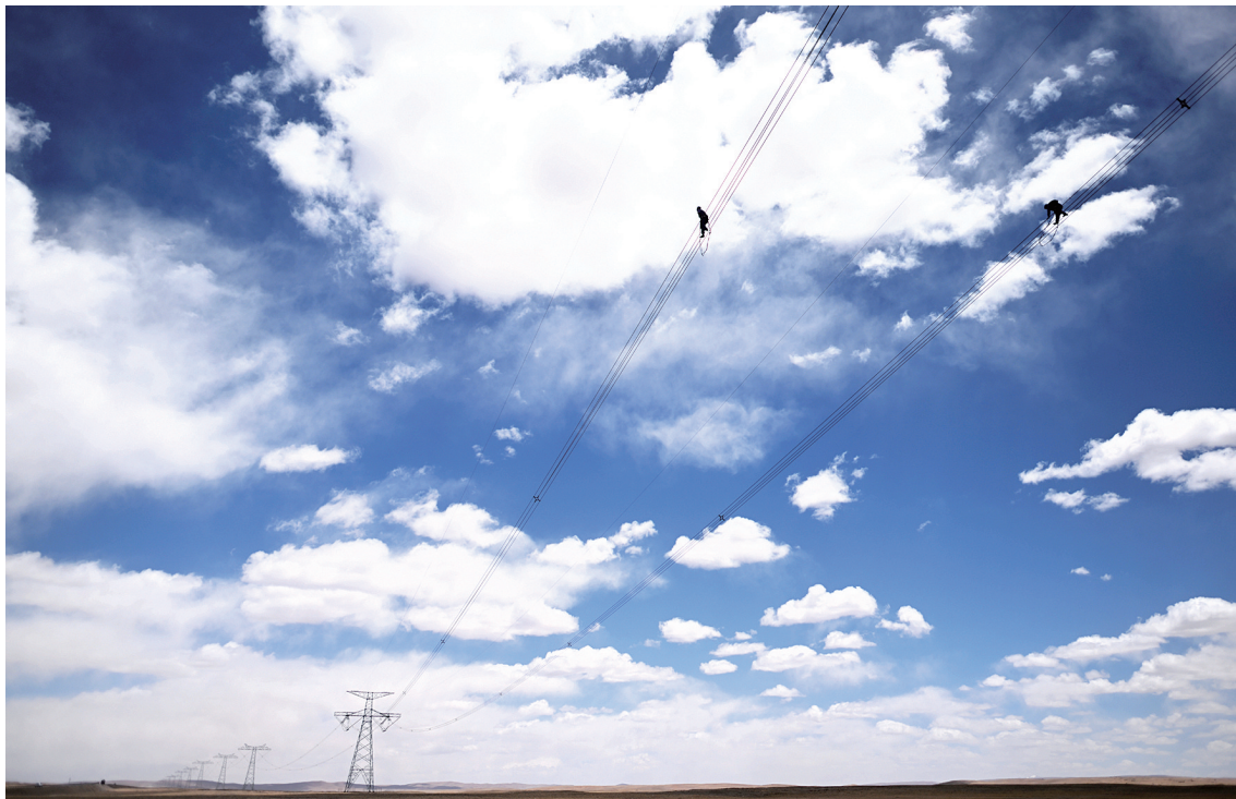
在青海省海西蒙古族藏族自治州格尔木市唐古拉山镇境内，检修人员在走线巡检中。
