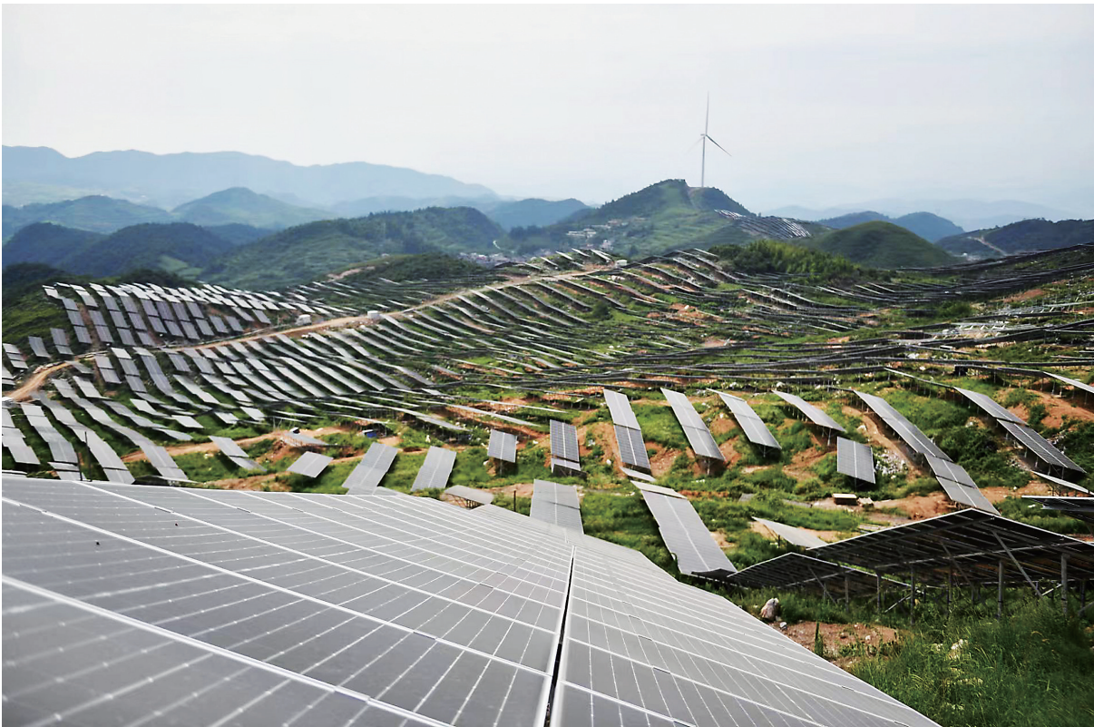
在湖南省冷水江市锡矿山,由金竹山电厂开发、运营的光伏项目是供电“新生力量”。迎峰度夏期间,光伏等新能源对于电力供应起到很好的补充、调剂作用。据了解,整个项目装机容量100万千瓦,包括锡矿山片区在内的一期50万千瓦已并网发电。图为锡矿山光伏项目。
