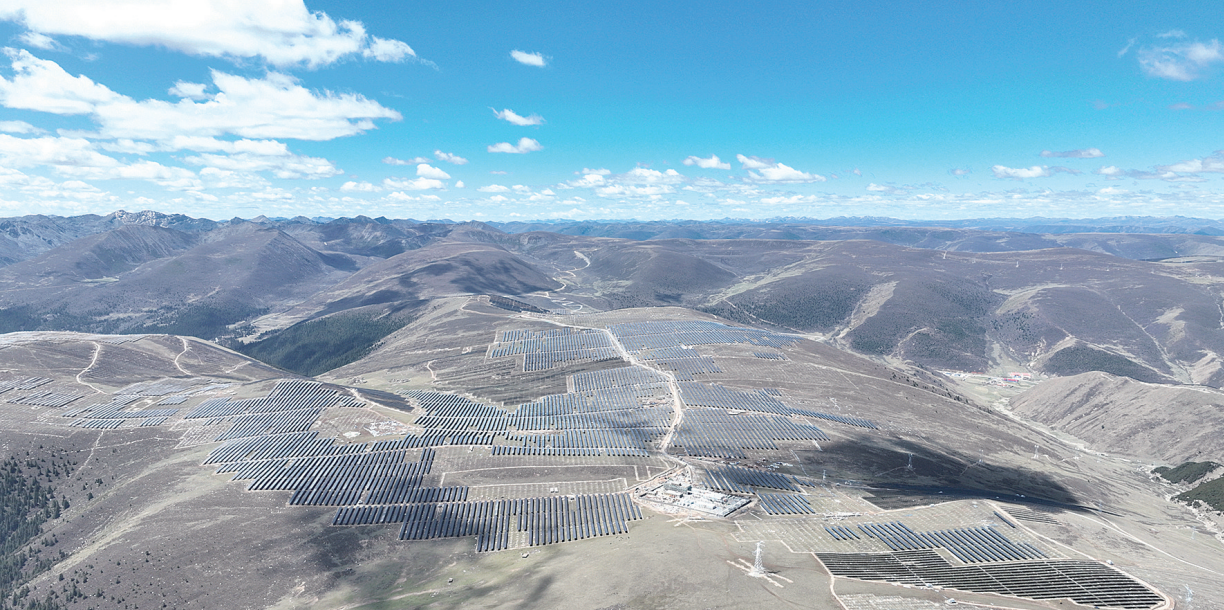
航拍柯拉一期光伏电站
