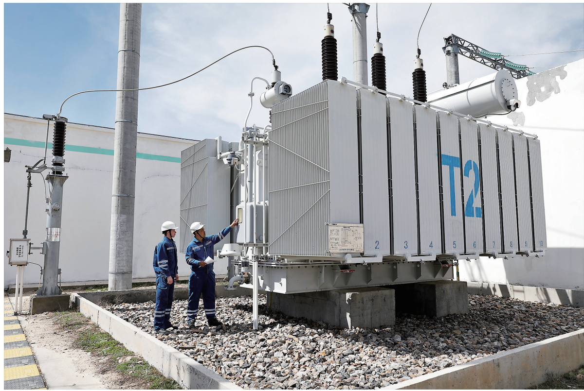
哈萨克斯坦是“一带一路”的首倡之地。在共建“一带一路”倡议与哈萨克斯坦“光明之路”新经济政策对接框架下,中哈率先开展产能和投资合作,形成涵盖52个项目、总金额逾212亿美元的项目清单。札纳塔斯100兆瓦风电项目就是其中之一。2021年6月,由中哈共同投资、中国企业承建的札纳塔斯100兆瓦风电项目竣工投产,成为当时中亚地区最大风电场,极大缓解了哈南部地区缺电状况。图为在哈萨克斯坦札纳塔斯,工作人员检查风电场变压设备。
