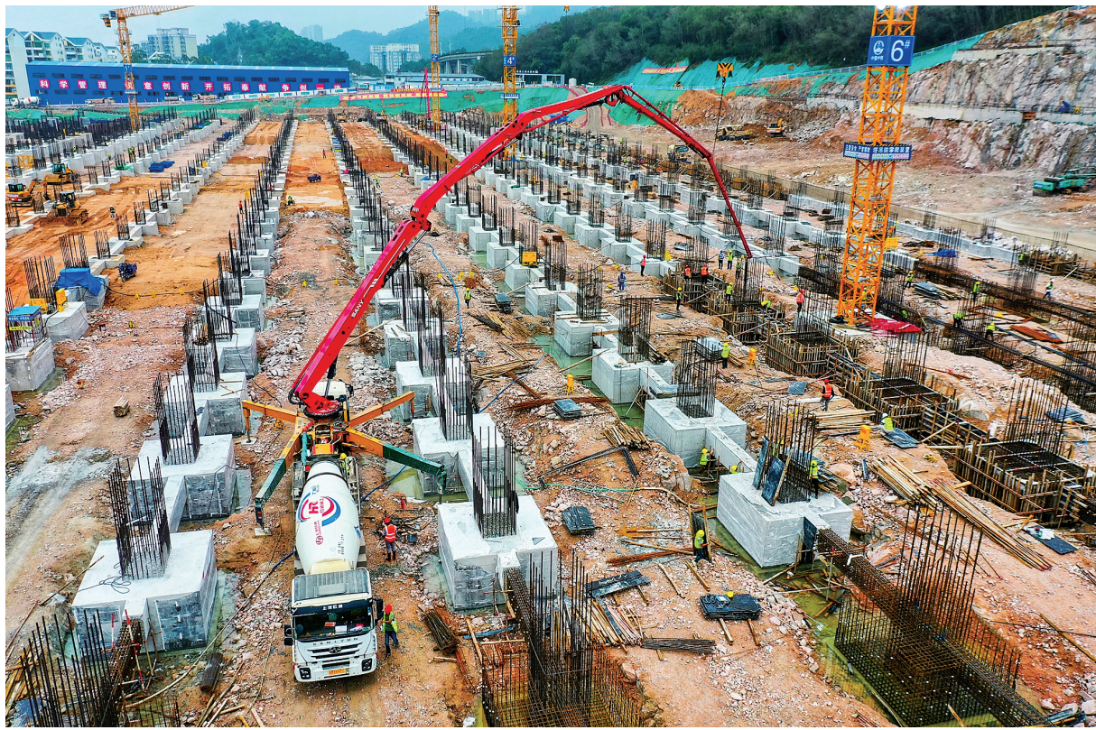
中铁上海工程局承建的深圳地铁5号线水径停车场总占地面积11.65公顷,采用地铁停车场层+结构转换层+工业上楼的竖向空间布局,以场站智慧系统与建筑一体化、环境生态与建筑一体化、光伏与建筑一体化等绿色低碳和智慧赋能的设计理念打造粤港澳大湾区绿色智慧地铁车辆场站。图为建设中的深圳地铁5号线水径停车场正在进行底板独立基础混凝土浇筑和钢筋笼绑扎作业。
