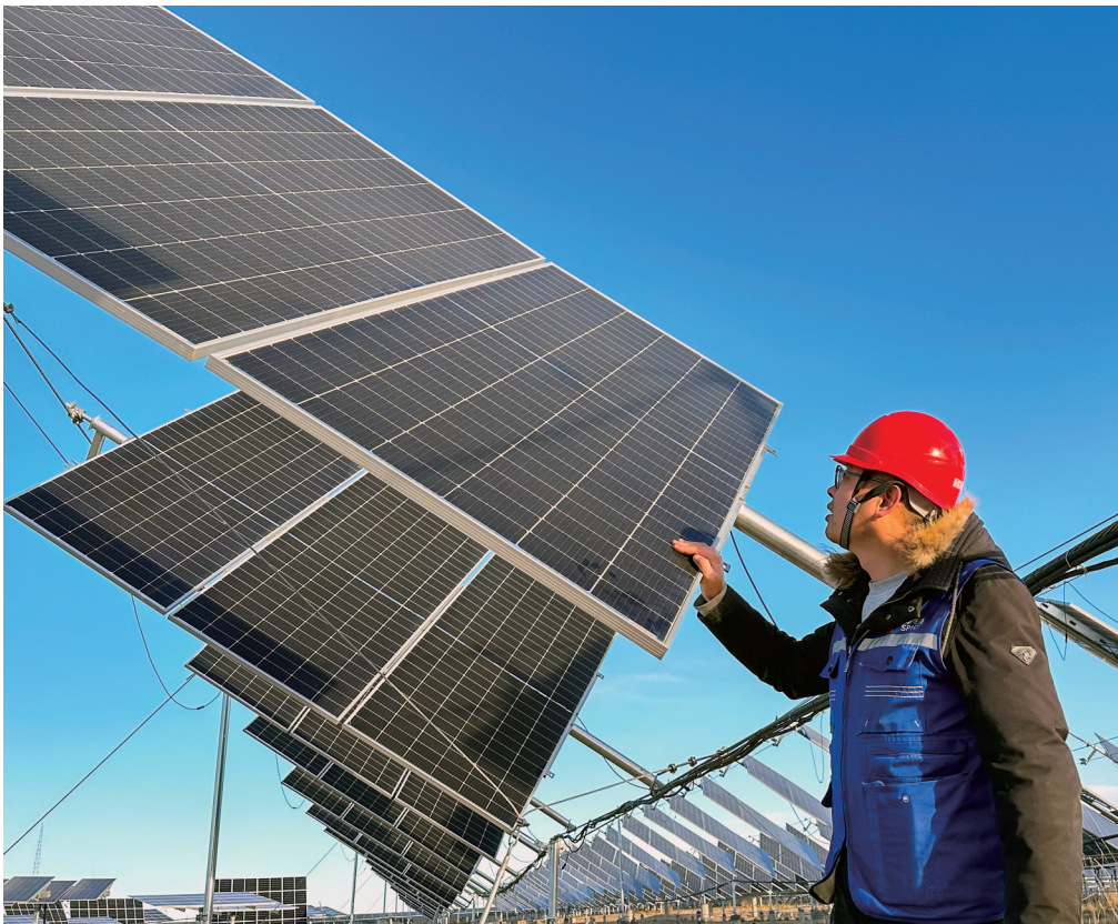
在青海省塔拉滩光伏发电园区里,工作人员在电站巡检。
