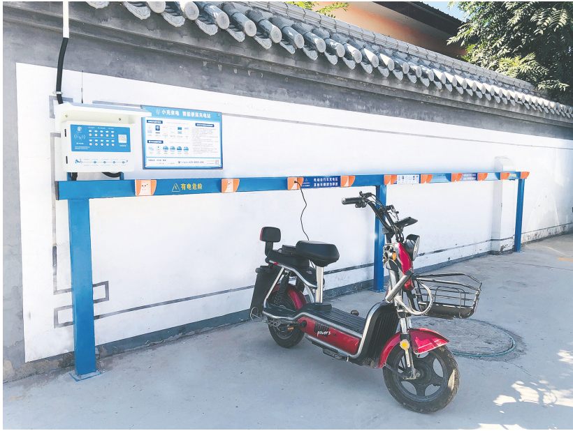
电动自行车便民充电站
