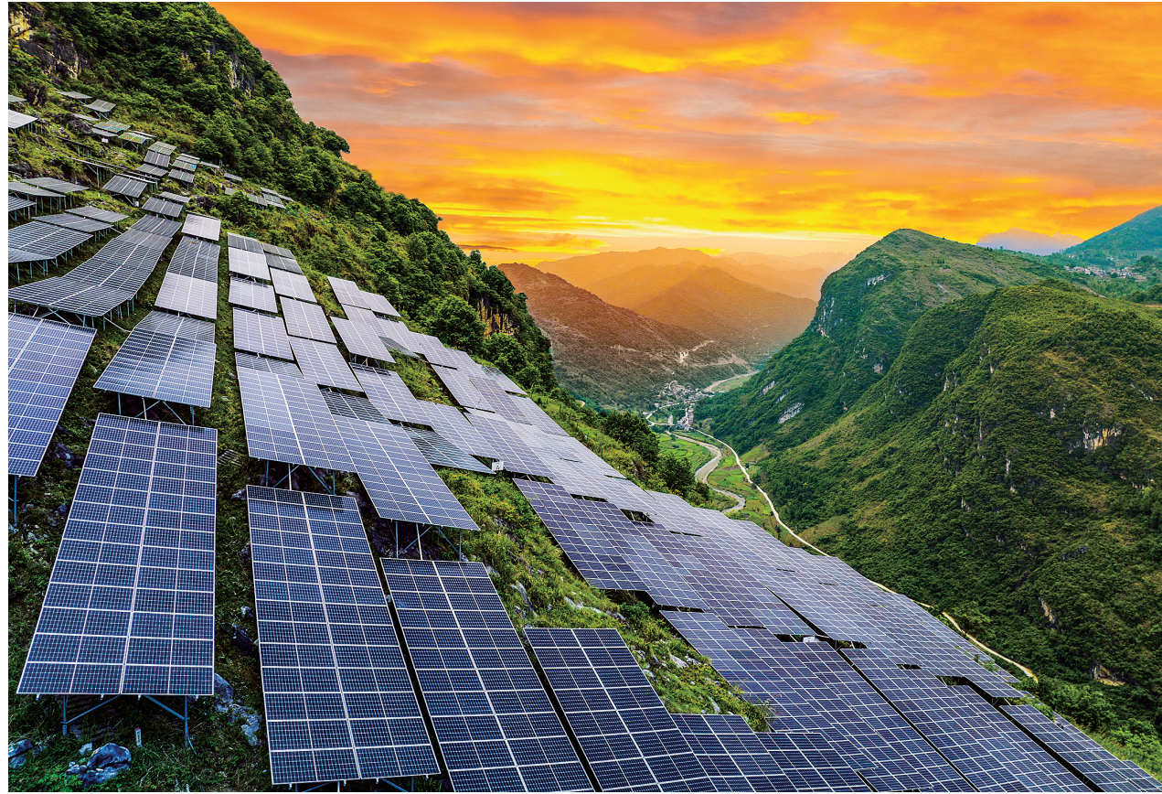
采用隆基绿能组件的贵州望谟40MW光伏电站
