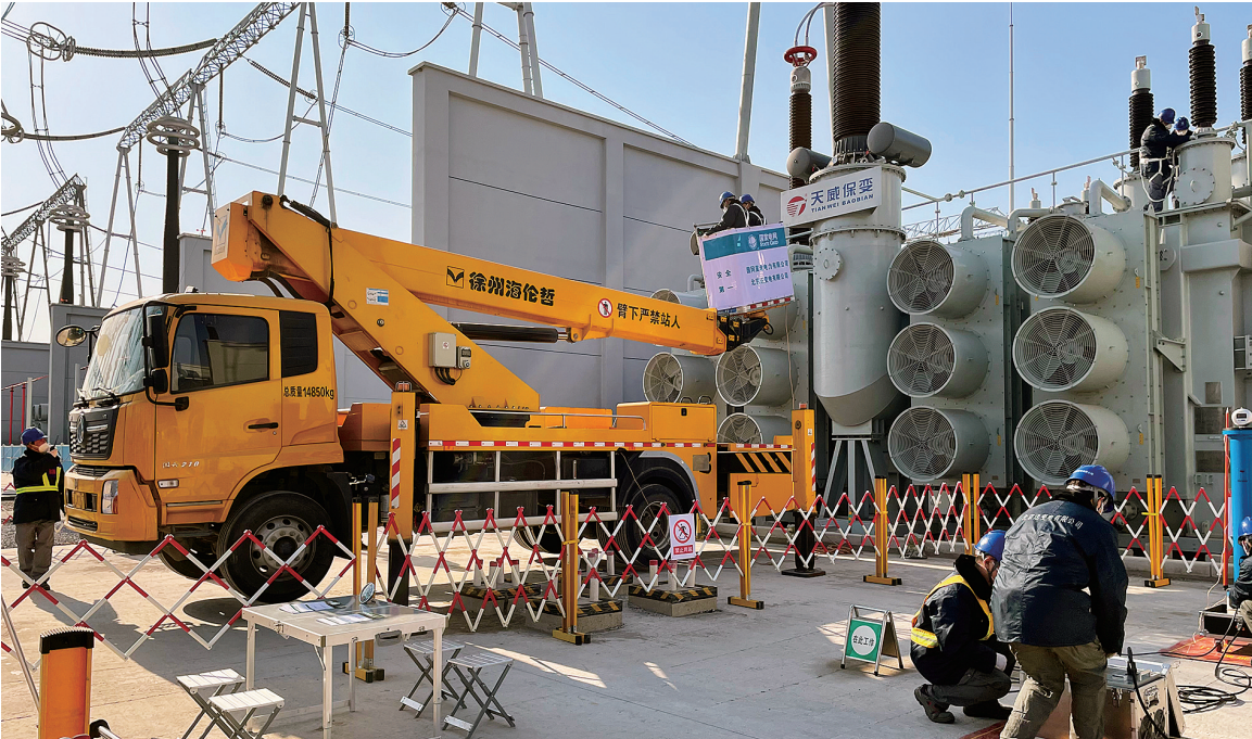
北京东1000千伏变电站扩建工程现场
