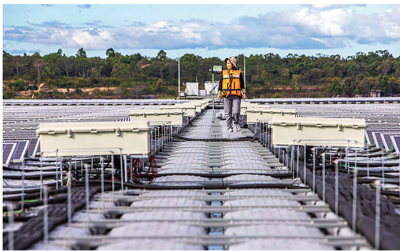
12月8日,一名工作人员在泰国乌汶府诗琳通水库巡查浮体光伏项目。
