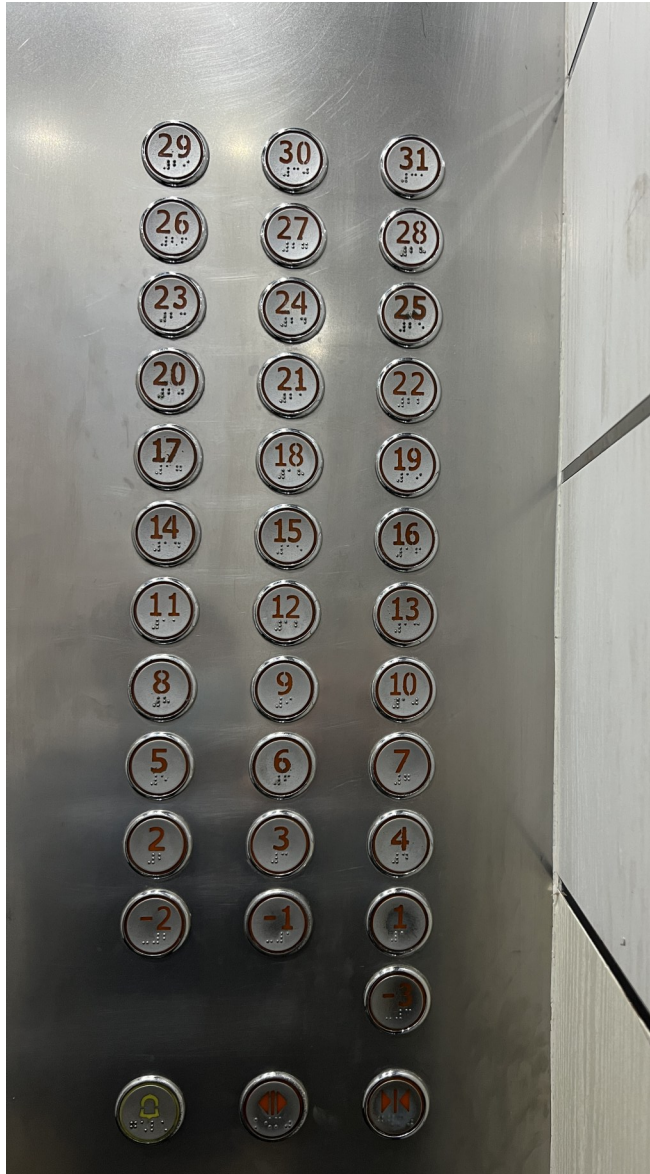
图为改造后的新电梯。
