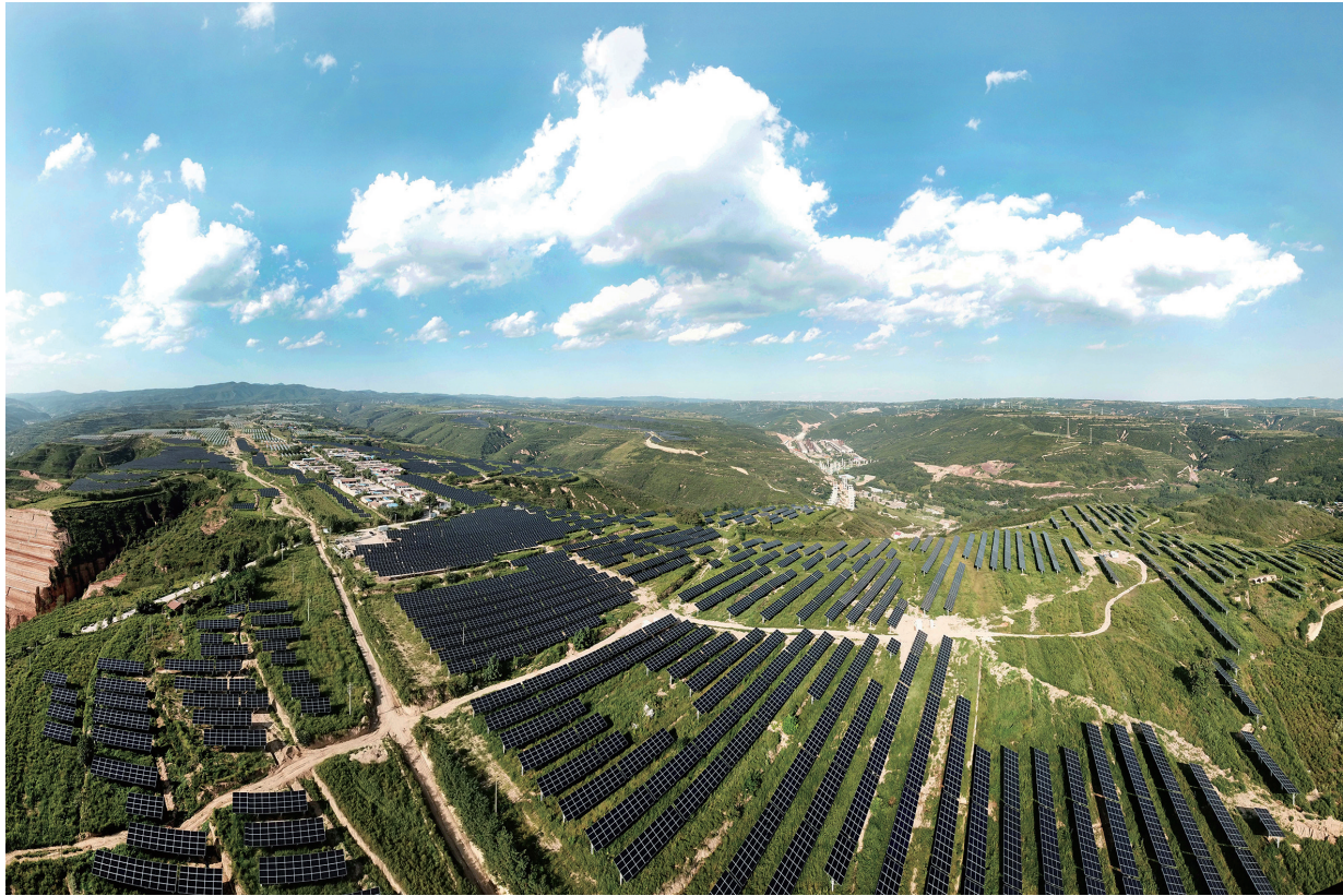
铜川刘家埡光伏电站
