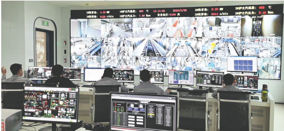
热电联产智能控制室
