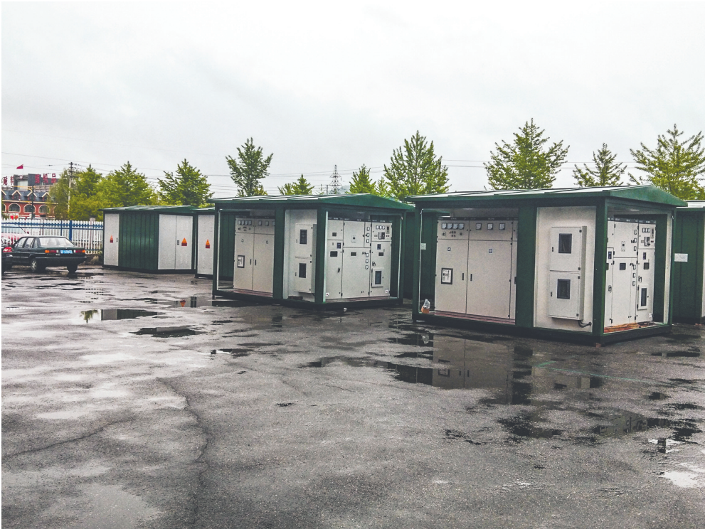
丹东大洋电力设备厂一隅
