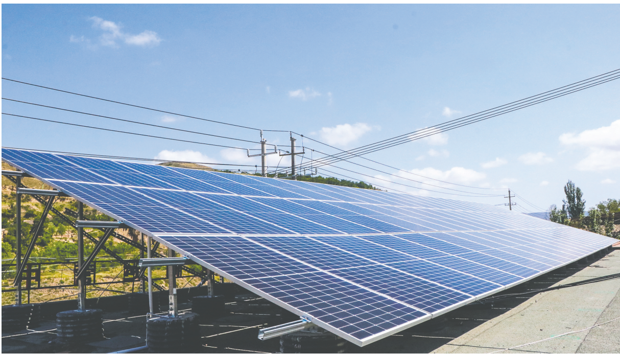
甘肃省定西市通渭县平襄镇孟河村光伏项目 (浙江正泰安能电力系统工程有限公同供图)
