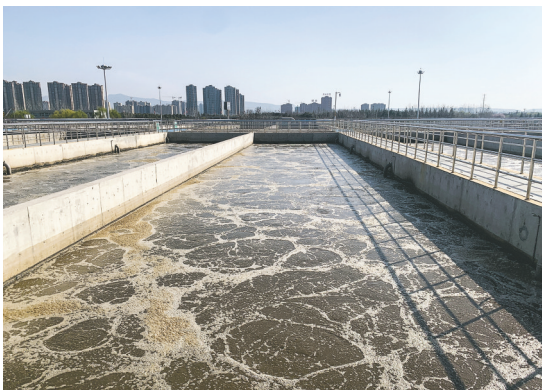
新区厂生化池
