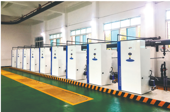
瀍东污水处理厂加药间
