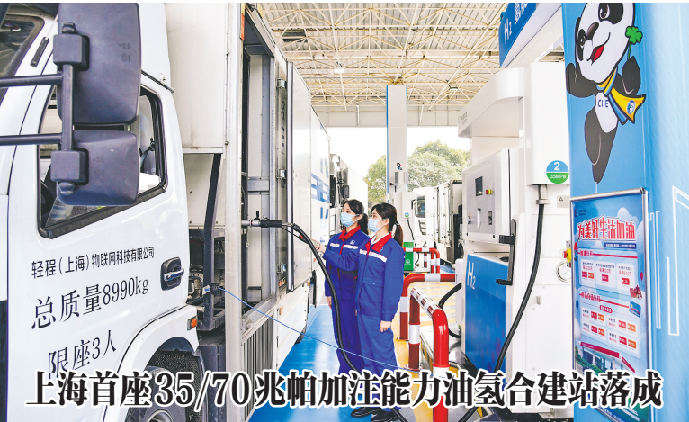
上海首座35/70兆帕加注能力油氢合建站落成 近日,上海首座能够同时满足35兆帕、70兆帕氢燃料电池汽车加注需求的油氢一体化综合能源供给站——中国石化上海石油青卫油氢合建站正式建成。该站日设计加氢能力为1000公斤,投用后将满足上海市青浦区、虹桥临空经济示范区的物流、环卫、公交等氢能车辆加注需求,助力上海氢能产业发展。
