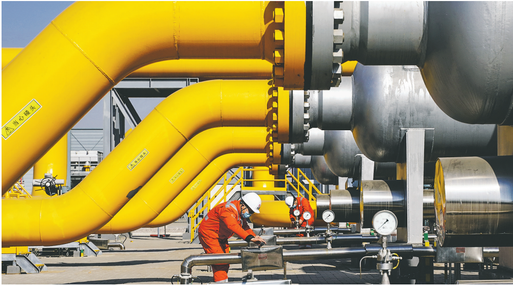
在位于河北省唐山市丰润区的国家管网集团北方管道有限责任公司秦皇岛输油气分公司唐山联络压气站，工作人员正在对天然气管网设备进行巡检。（资料图片） 新华社发
