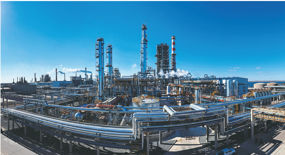
建成投产的大庆石化炼油结构调整转型项目装置
