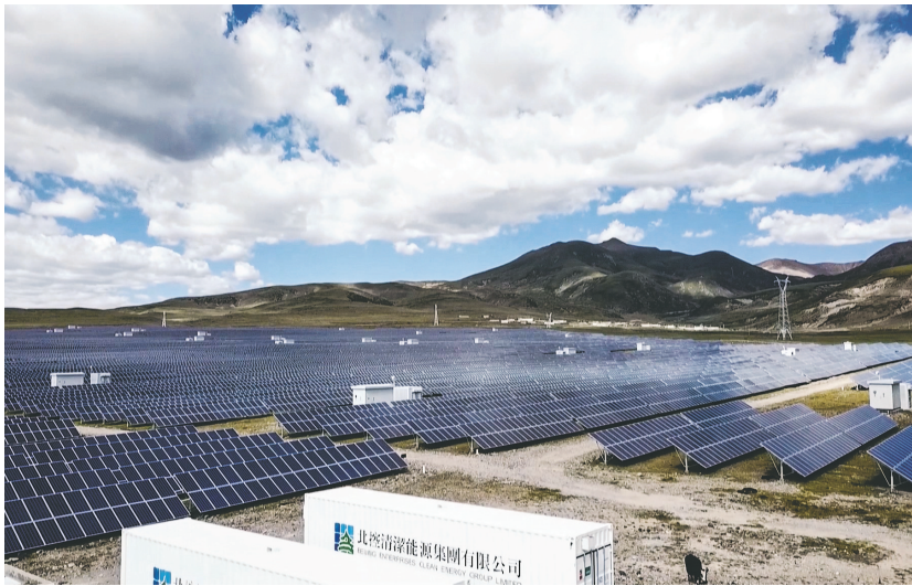
北控集团拉萨市当雄县光伏发电扶贫项目
