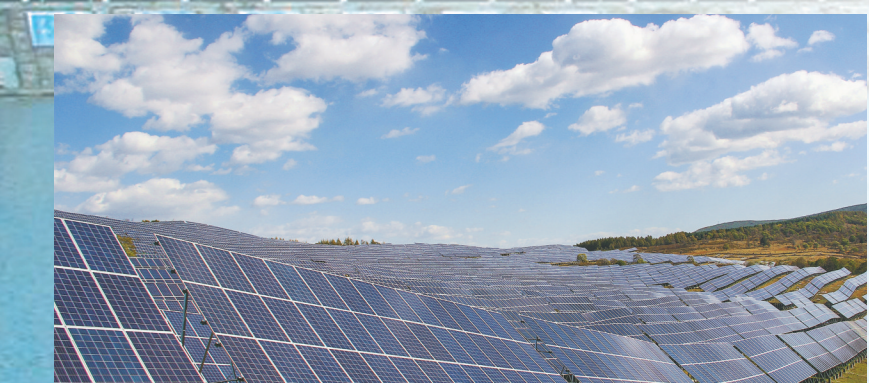
汪清县光伏扶贫项目
