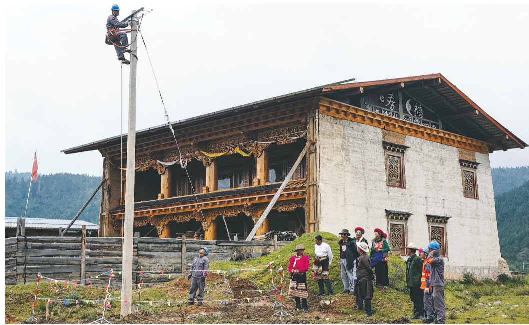
南方电网云南电网公司迪庆供电局员工在“三区三州”深度贫困地区迪庆香格里拉小中甸镇联合村里小组开展配变台区改造。
